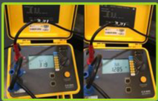
การตรวจเช็คค่า ความเป็นอนวน แบบ (PI) ด้วยมิเตอร์ รุ่น CA6505 บอกอะไร?
